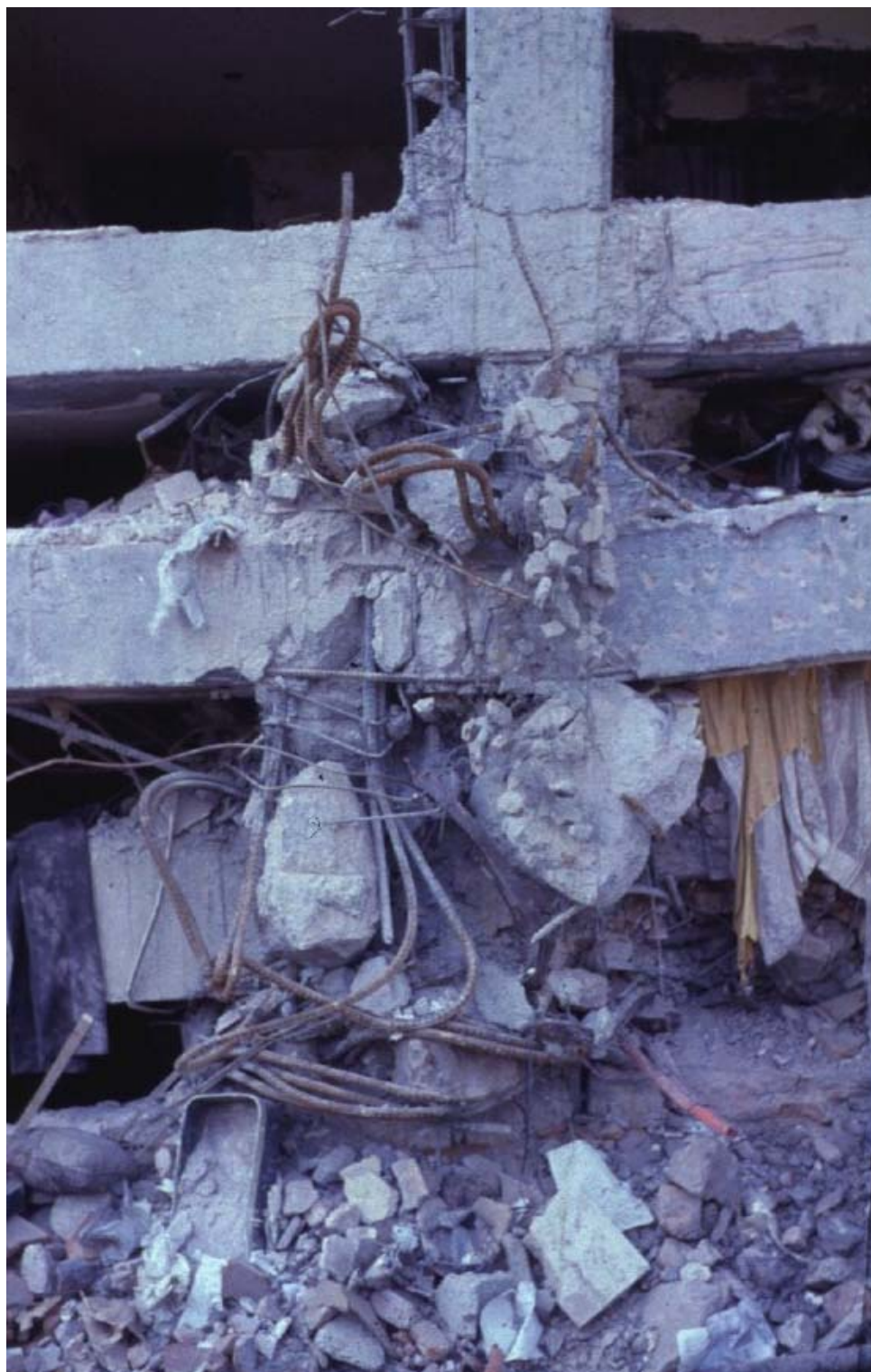
Καταστροφικές συνέπειες από τον σχηματισμό μηχανισμού ορόφου
